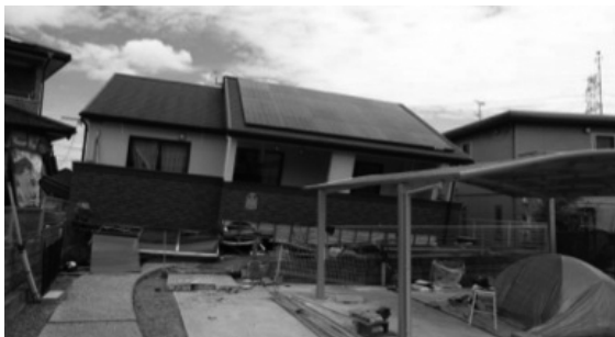
写真1 倒壊した木造住宅
