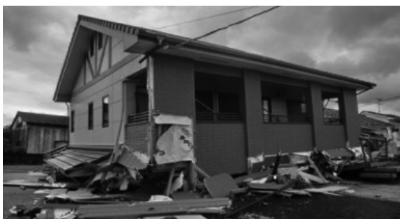
写真3 倒壊した木造住宅
